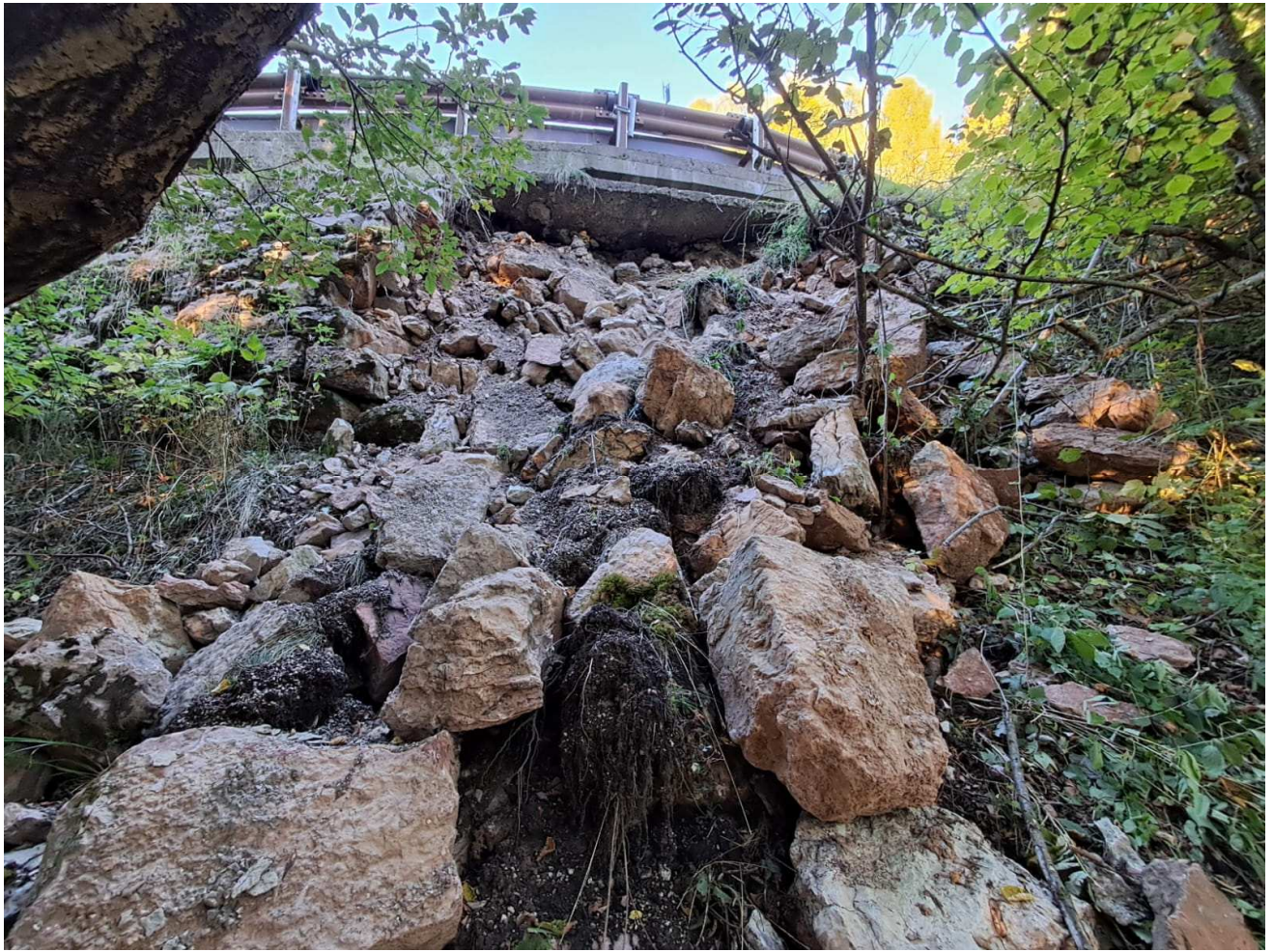
Foto n. 2 – Vista da valle del tratto di muro crollato..
