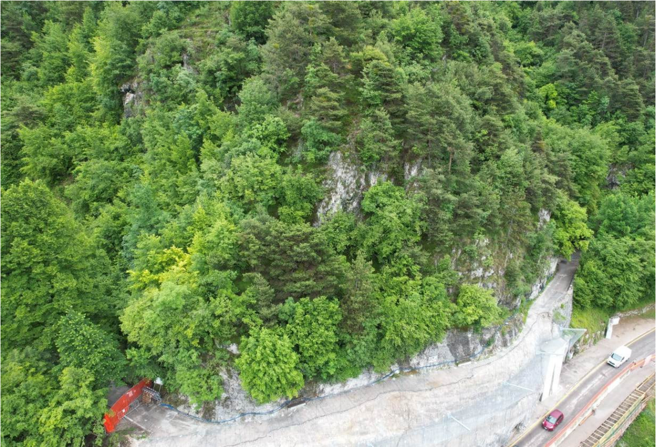
Foto n. 2 – Nella fotografia ripresa con drone è ben visibile la porzione di versante a monte del percorso ciclopedonale interrotto, dal lato di Mezzolago.
