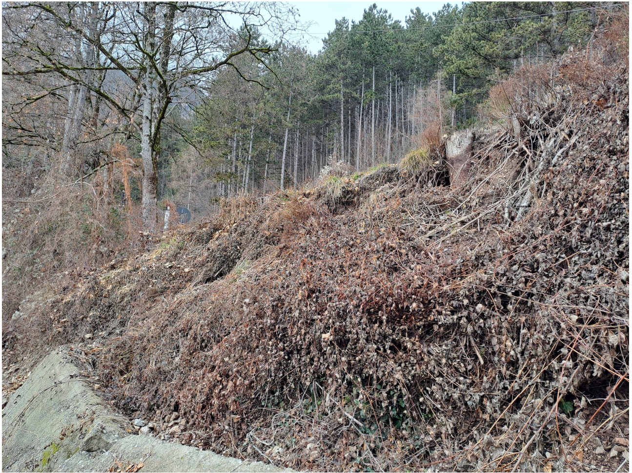
Foto n. 2 – esito del crollo del tratto di muratura di sottoscampa della SP14, vista dalla strada interpodereale/comunale che transita in fregio al muro direzione Tuenno - Tovel.
