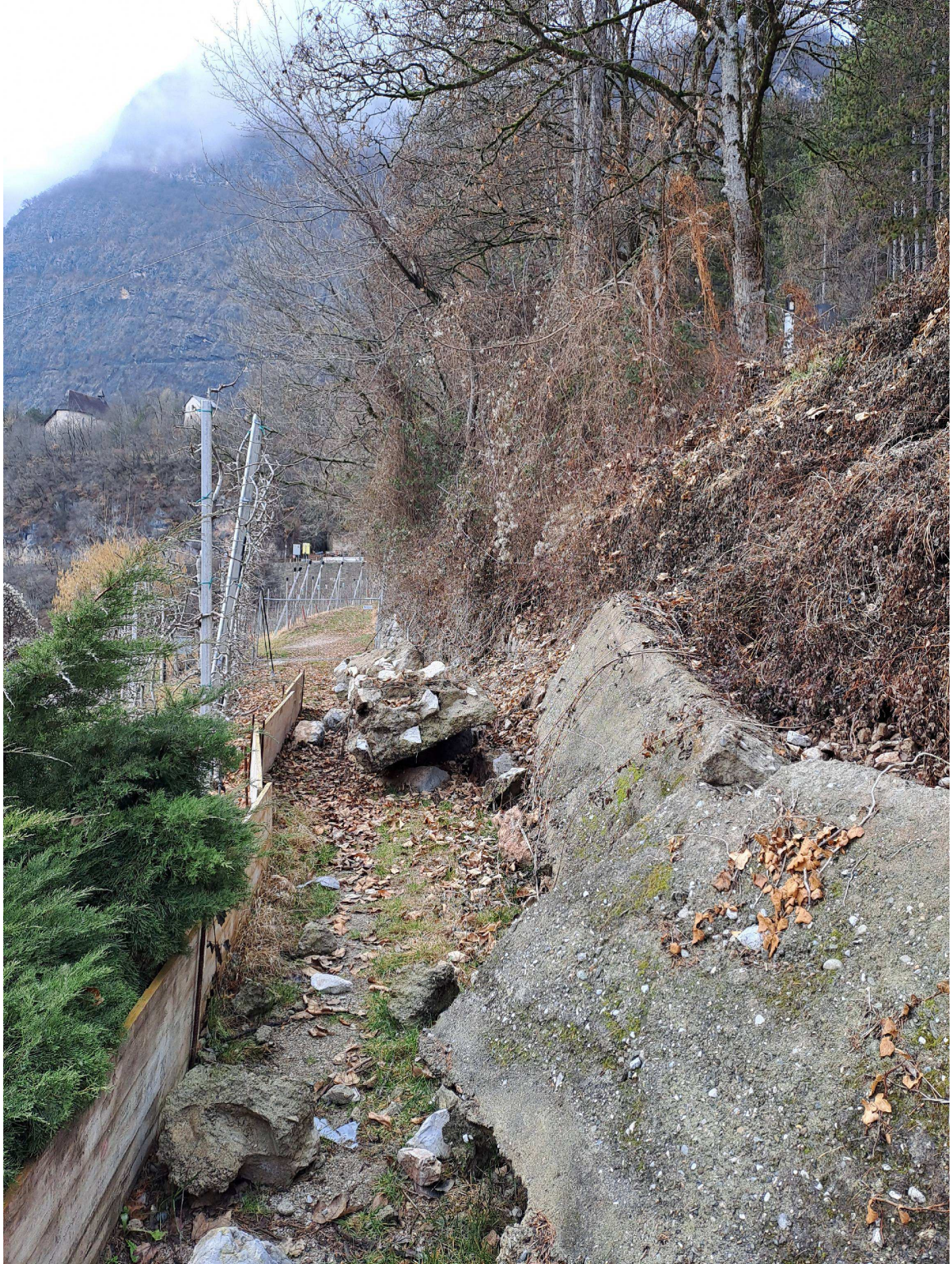
Foto n. 1 – esito del crollo del tratto di muratura di sottoscarpa della SP14, vista dalla strada interpodereale/comunale che transita in fregio al muro direzione Tuenno - Tovel.
