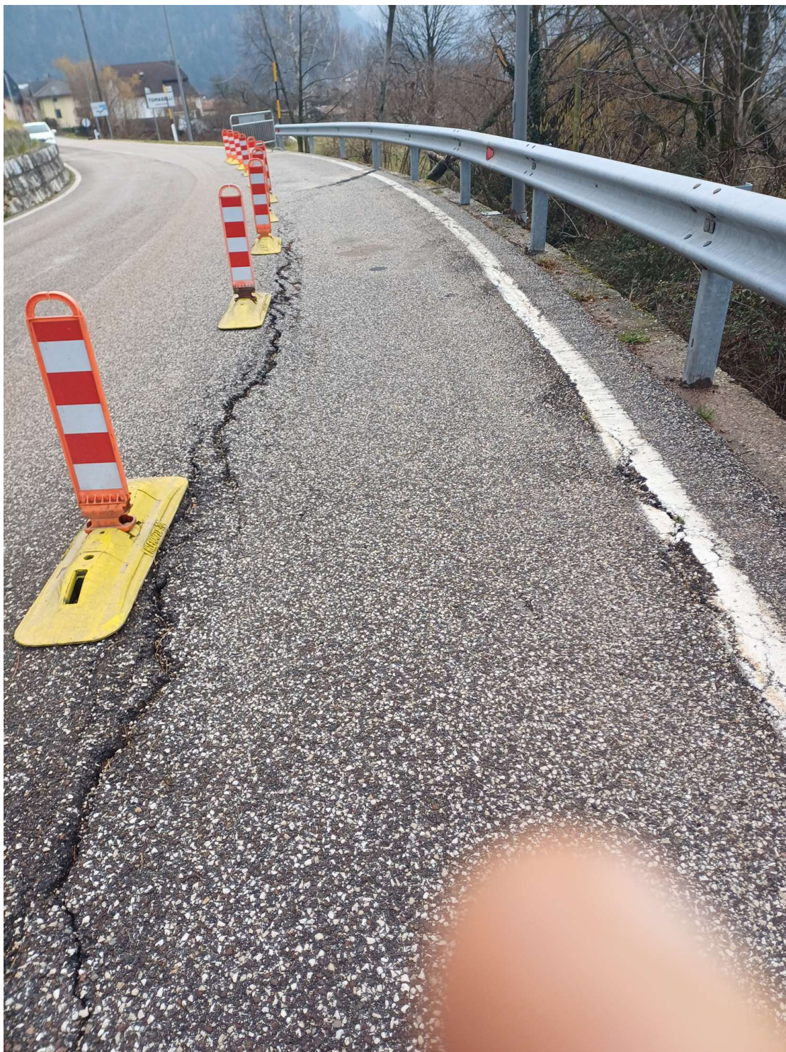
Foto n. 1 Vista della SP 39 di Samone nel tratto in prossimità della pr. km 0+300 circa, ripresa dal lato dell'abitato di Samone. In primo piano la porzione di valle della carreggiata, interdetta al traffico a seguito del cedimento del piano viabile
