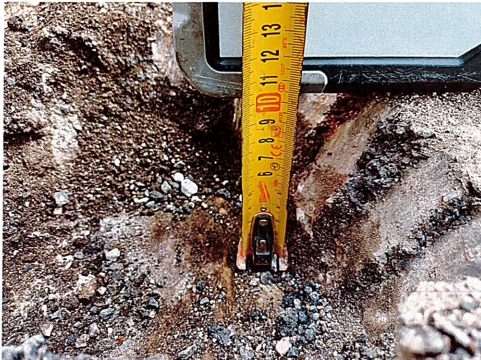
Foto 4 – spessore asfalto circa 10,5 cm – provino 3 con messa in luce doppio strato di guaina
