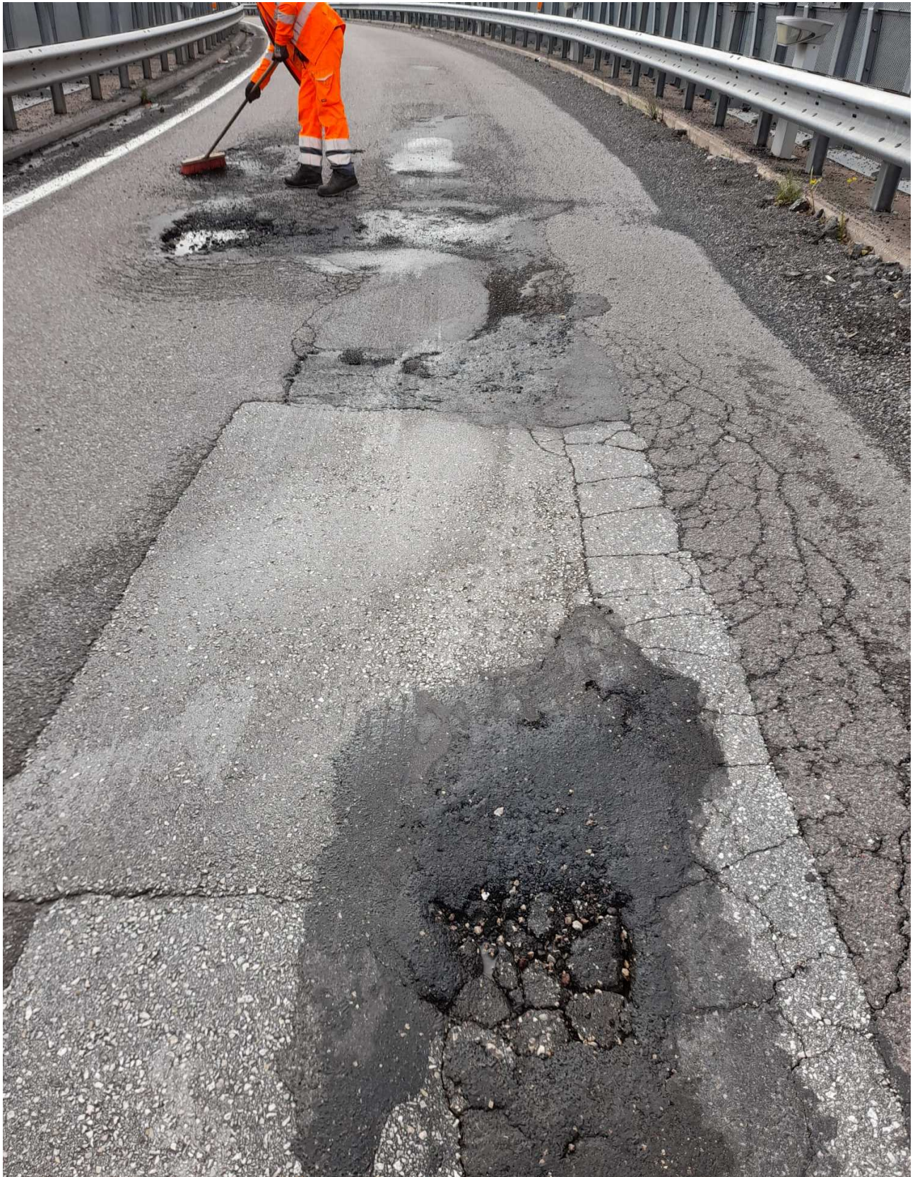
Foto n. 1 – Buche e ammaloramento della pavimentazione sull'impalcato del sovrappasso "Interporto", al km 1,550 circa della S.P. 235 dell'Interporto a seguito dell'evento meteo del 10 ottobre 2024.
