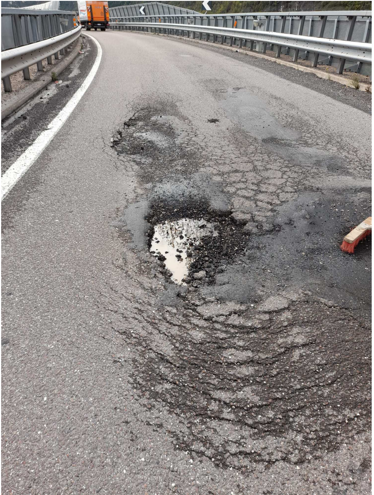
Foto n. 2 – Particolare di alcune delle buche formatesi in data 10 ottobre 2024, con esposizione della sottostante guaina di impermeabilizzazione della soletta.
