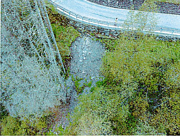
Foto 5 – Vista movimento franoso di valle km 83+400
