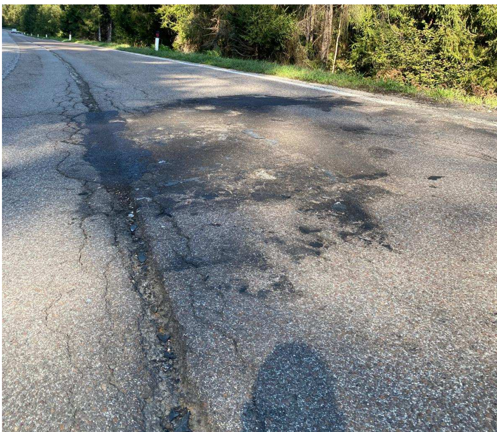
SP 206 di Marilleva; ammaloramenti diffusi e perdita delle caratteristiche funzionali del manto stradale in corrispondenza di un tratto in curva interessato da un incendio di autoveicolo in data 17/08/2024
