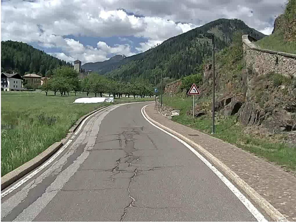
SP 202 di Ossana km 0+400 fessurazioni reticolari, buche profonde e cedimenti estesi in un tratto in discesa a forte pendenza interessato da elevato transito di biciclette per l'uso promiscuo condiviso tra la SP e il percorso ciclabile dell'alta Val di Sole
