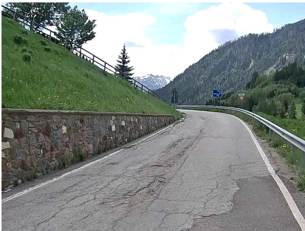
SP 87 dir Comasine km 0+150; ammaloramenti diffusi con principio di collasso del intero corpo stradale aggravato dai lavori in somma urgenza per la ricostruzione della rampa stradale al km 0+900 in seguito all'evento franoso del 01/04/2024
