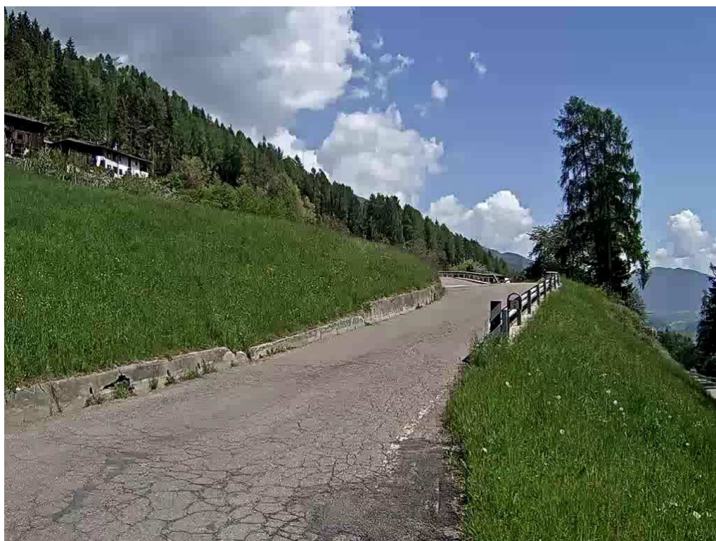
SP 141 km 2+390 fessurazioni reticolari con principio di collasso del intero corpo stradale innescato a partire dal 01/04/2024
