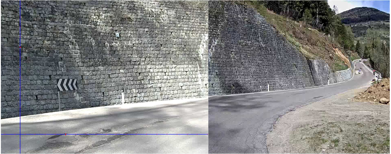
SP 87 km 6+500; ammaloramenti profondi in corrispondenza del tornante, sullo sfondo visibile la frana del 01/04/2024
