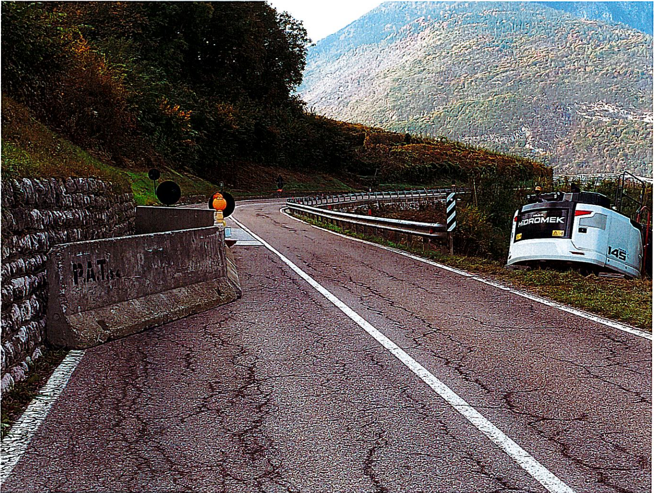
Foto n. 3 – Messa in sicurezza provvisoria della corsia di marcia verso valle tramite new-jersey in cls, con regolazione del traffico mediante senso unico alternato a vista.
