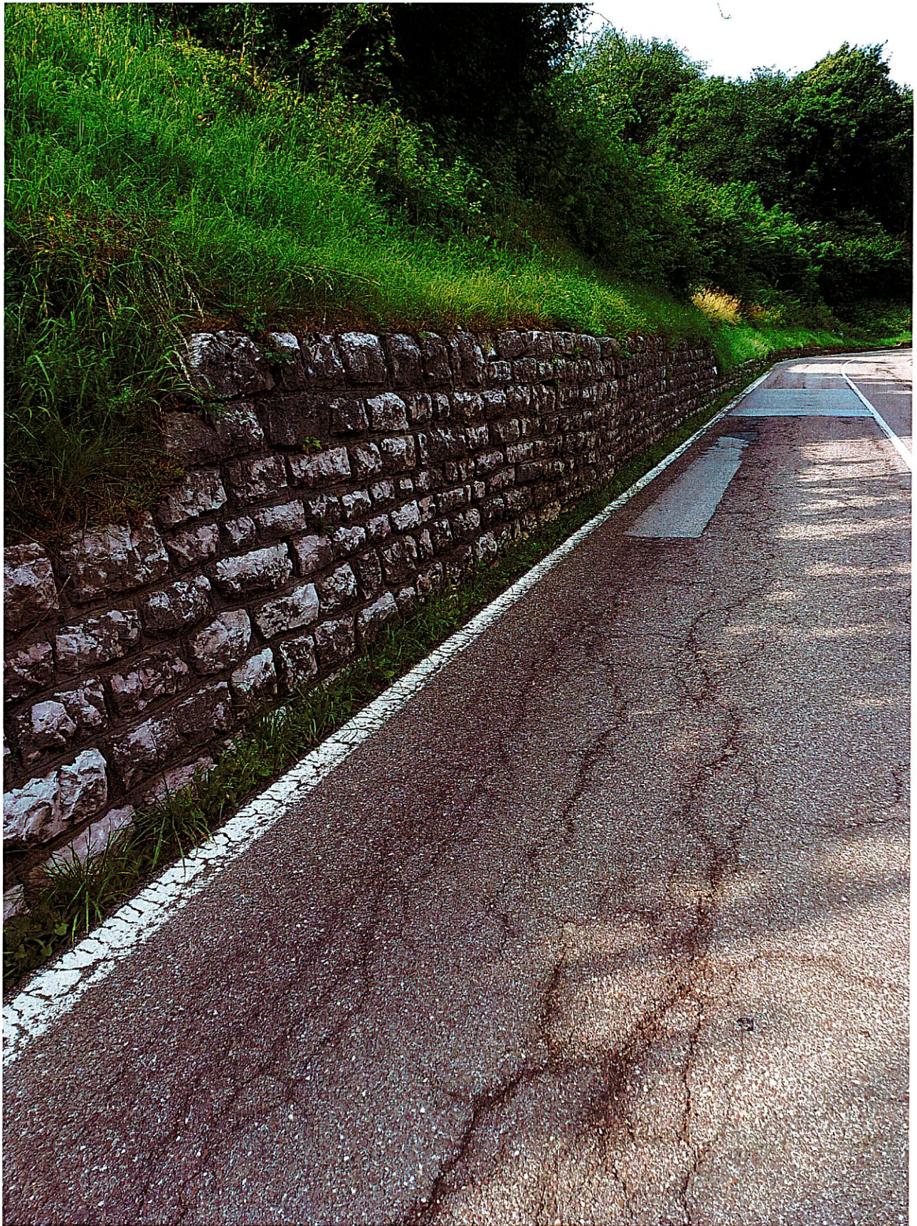
Foto n. 1 – Il muro di contropipa al km 3,150 circa della S.S. 421. Si noti il rigonfiamento della parte centrale.
