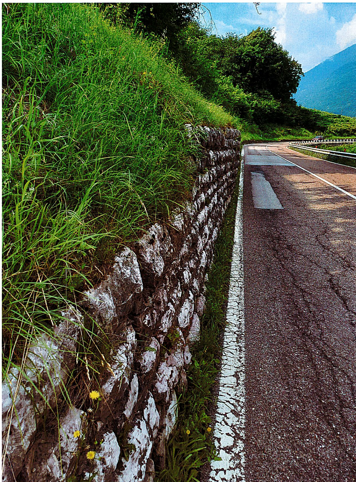
Foto n. 2 – Particolare della deformazione del paramento del muro, che invade la corsia di marcia ed è a rischio di collasso.
