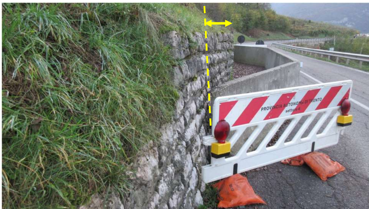
Foto 1: vista laterale del muro dove è evidente lo “spanciamento” verso la strada
