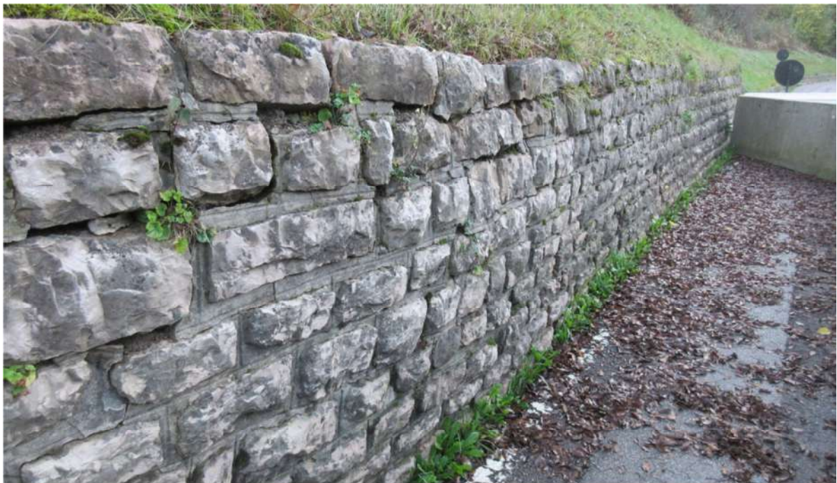
Foto 2: vista del muro dove si evidenziano i blocchi ormai non più solidali al resto del muro a causa del deterioramento degli strati di malta
