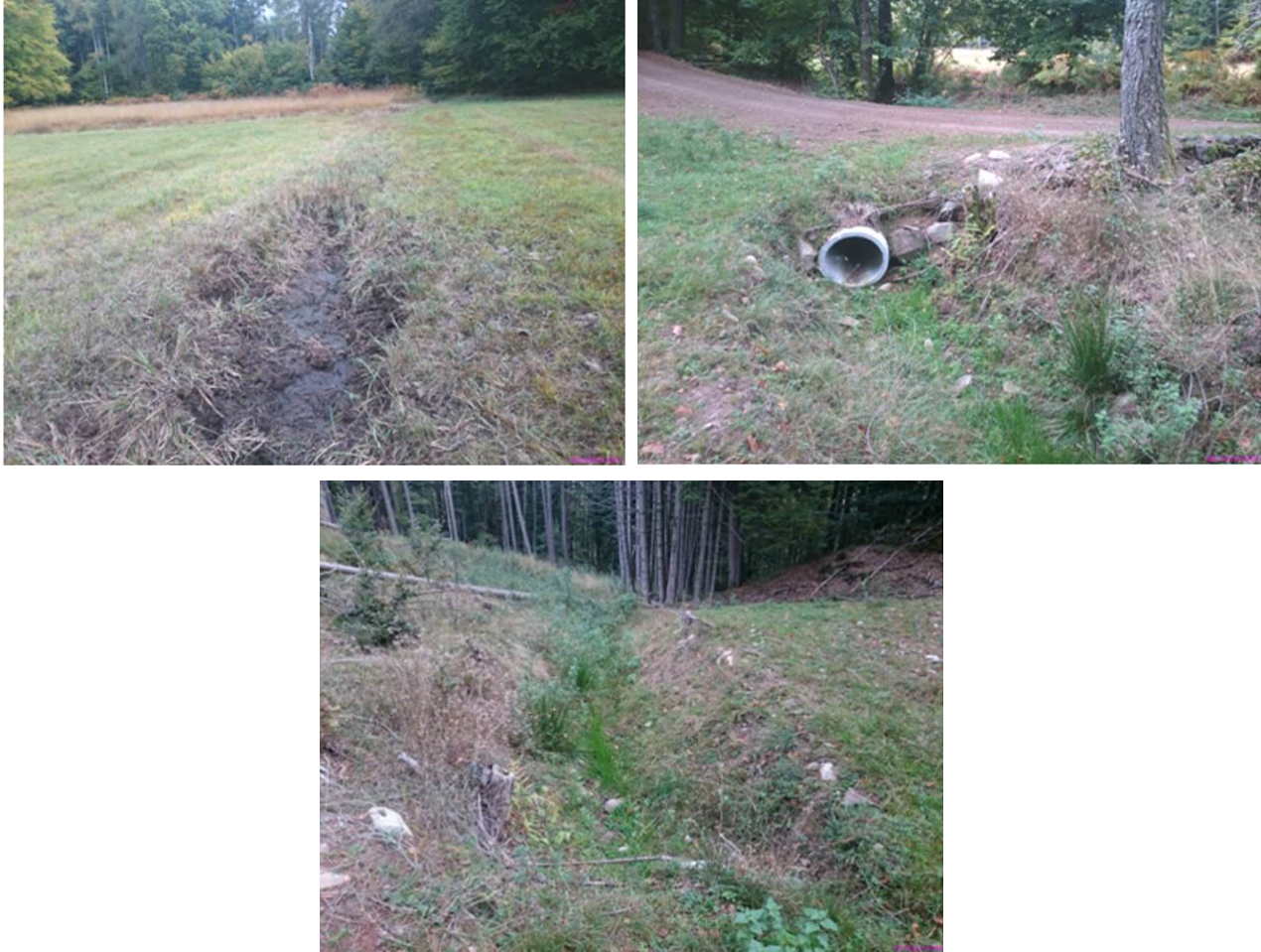
Fig. 2.8-2.10 – Collettore che raccoglie le acque nella zona prativa pianeggiante recentemente bonificata e le scarica nella vallecchia
