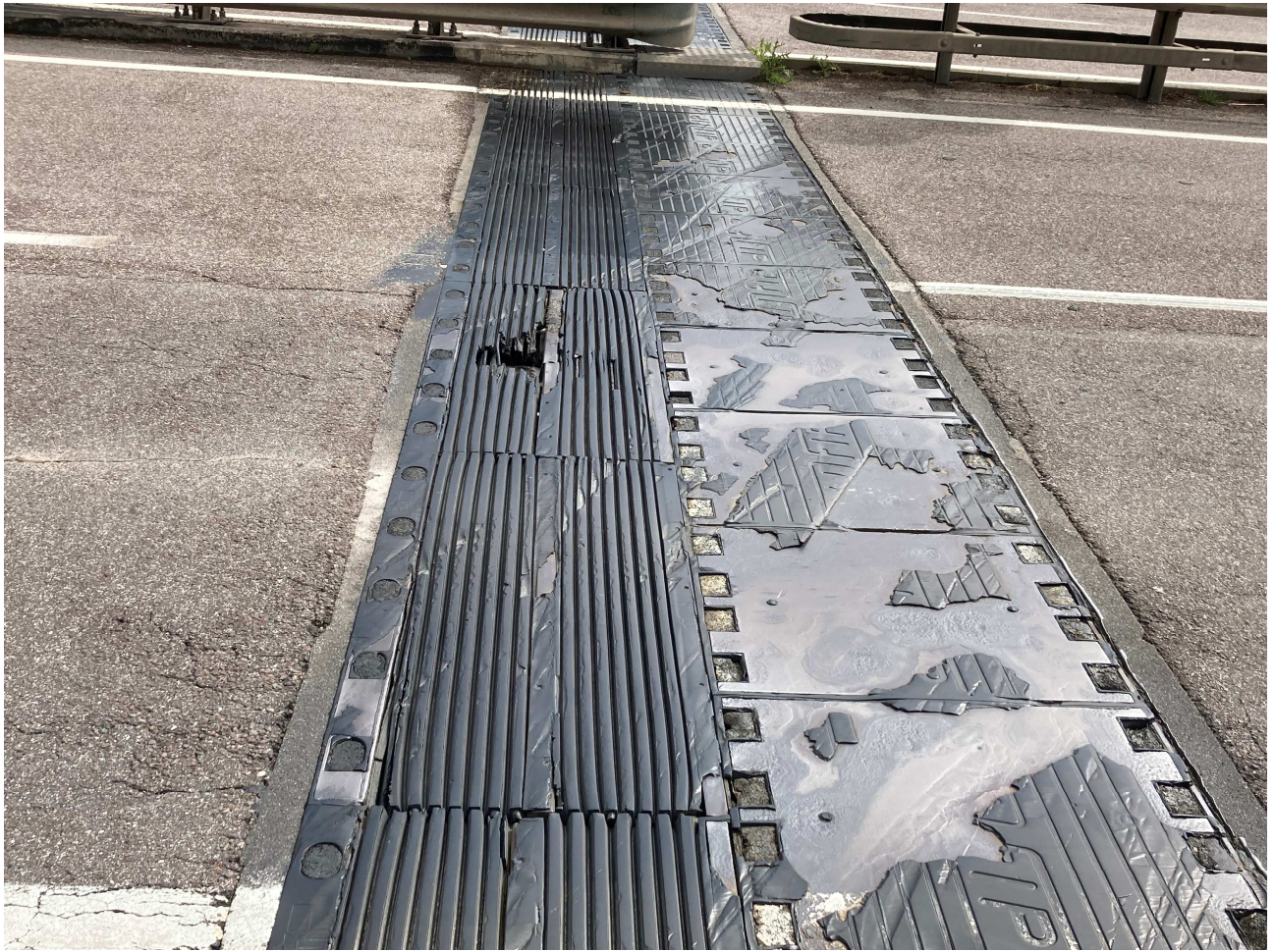
Foto n. 2 – Particolare della porzione di giunto danneggiata. Si noti il buco sul piano viabile in corsia di marcia, pericoloso specialmente per i motocicli.
