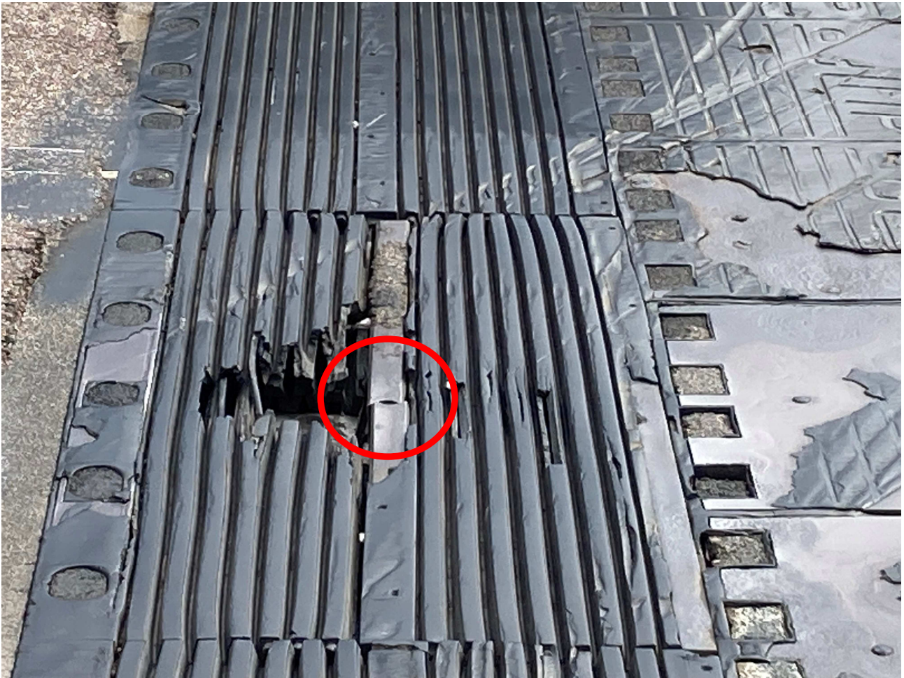
Foto n. 3 – Dettaglio del soffietto danneggiato. Si noti la barra metallica trasversale rotta a metà nel punto cerchiato in rosso.
