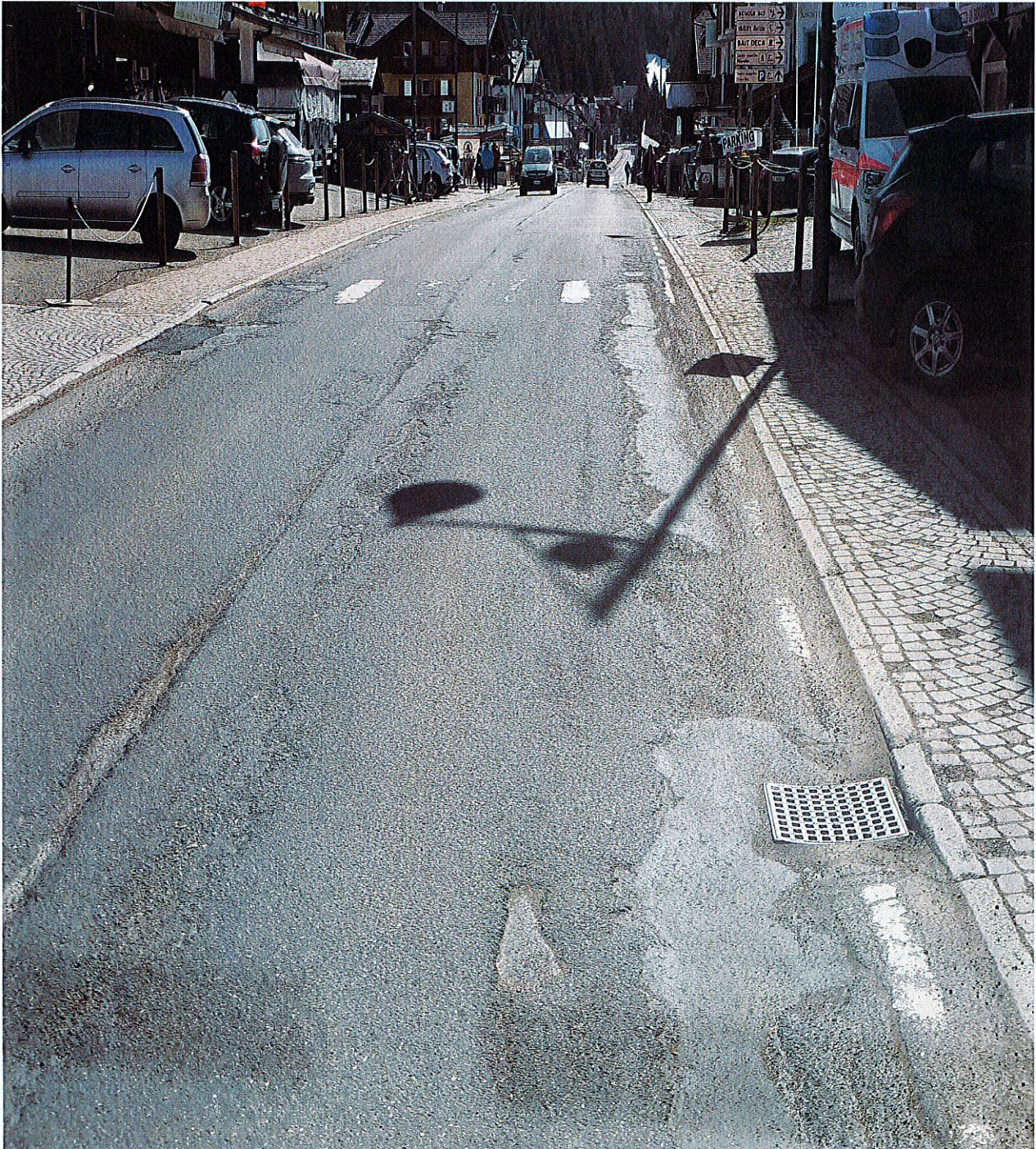
FOTO n. 6 – SS n. 48 delle Dolomiti variante Canazei nel comune di Canazei Rappezzi e cedimenti tratto dal km 0+000 al km 0+800
