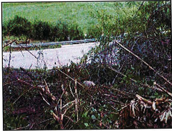
Foto n.1- Vista paramassi danneggiato ed SP56
