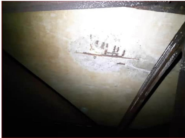
Particolare zona soffitto ammalorata
