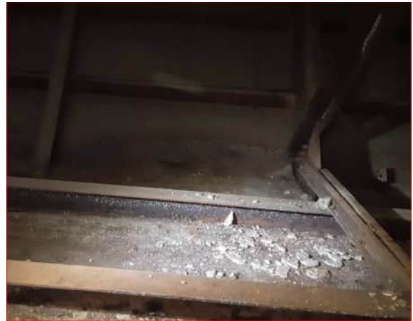
Particolare calcinacci distaccatisi dalla soletta
