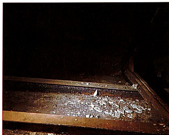
Particolare calcinacci distaccatisi dalla soletta
