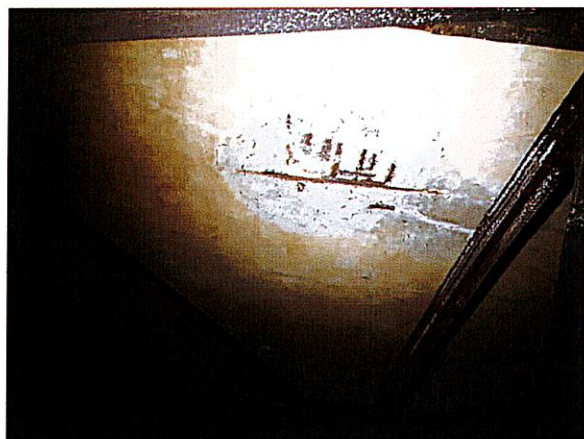
Particolare zona soffitto ammalorata
