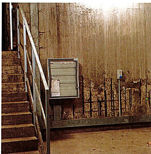
Quadro elettrico installato nel locale tecnico
