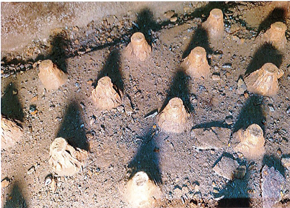
Foto 11 – vista ravvicinata dei bulloni con evidente perdita di sezione di dadi e gambo
