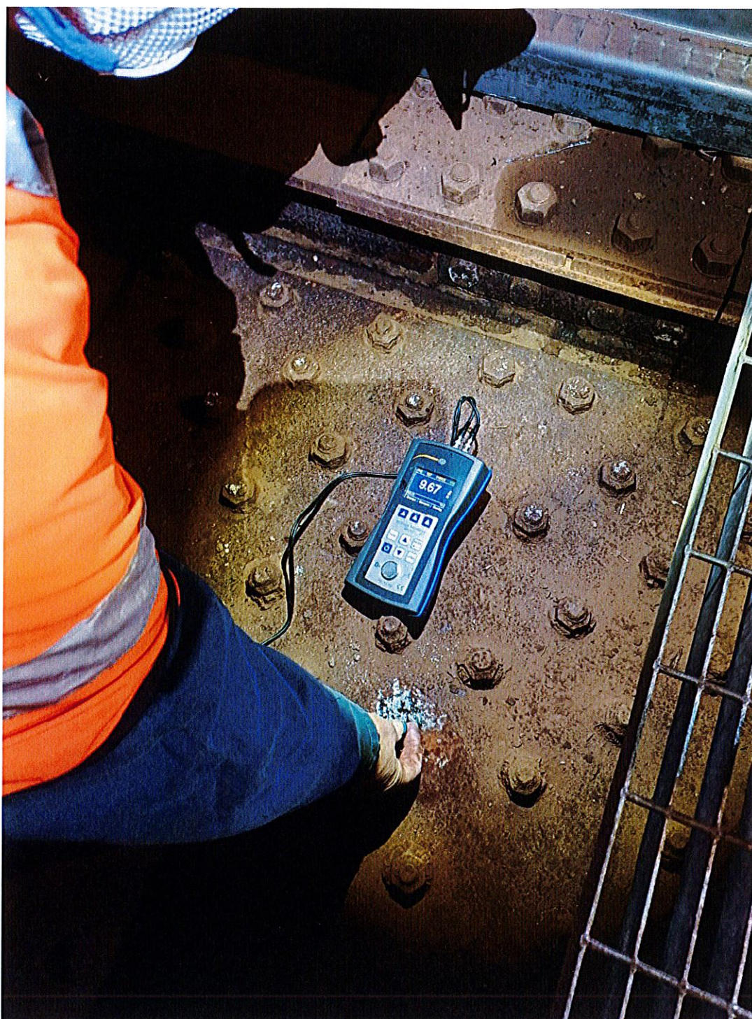
Foto 2- Campata 3 giunto G4 – riduzione dello spessore del coprigiunto centrale da 15 mm originari a 9,67 mm rilevati
