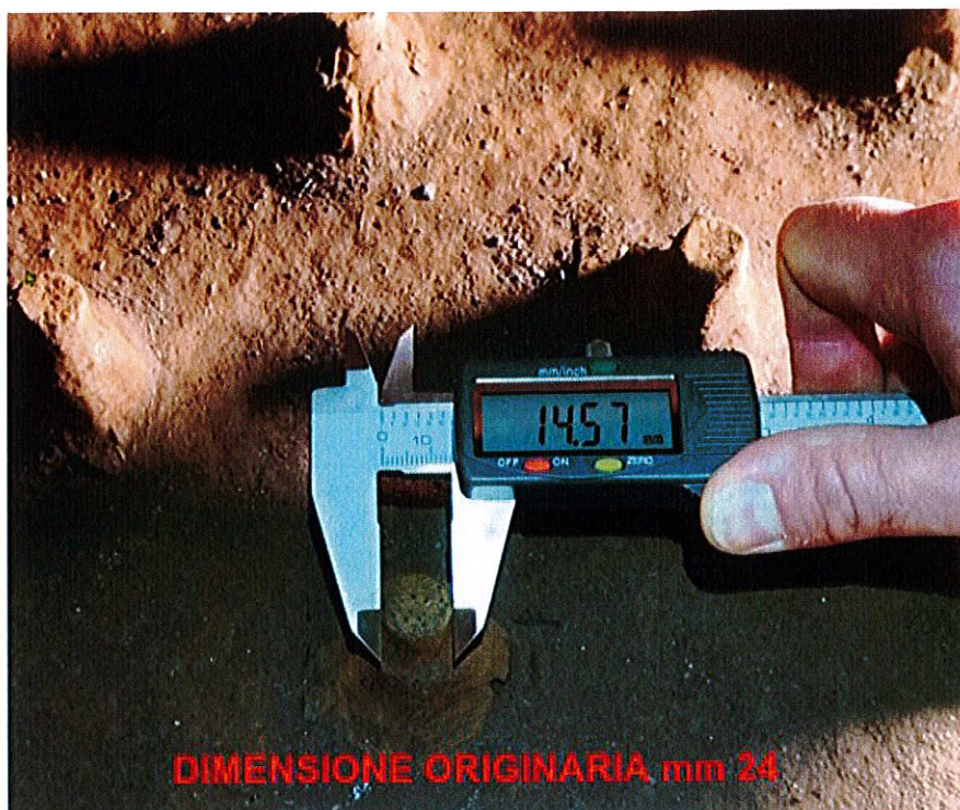
Foto 12 – misurazione a campione del gambo bullone. Dagli originari 24 mm (bullone M24) si rilevano oggi 14,57 mm di spessore, con evidente perdita di sezione.
