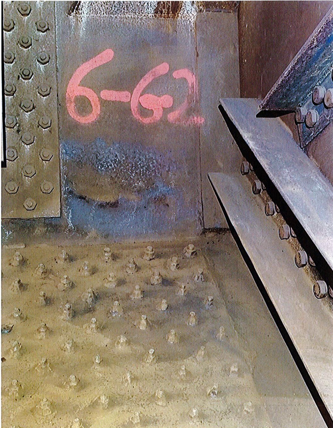
Foto 9 – Campata 6 giunto G2 - I dadi delle unioni bullonate del fondo del cassone, specialmente quelle più sollecitate in mezzaria (G2 e G3), presentano una riduzione di sezione anche del 70%
