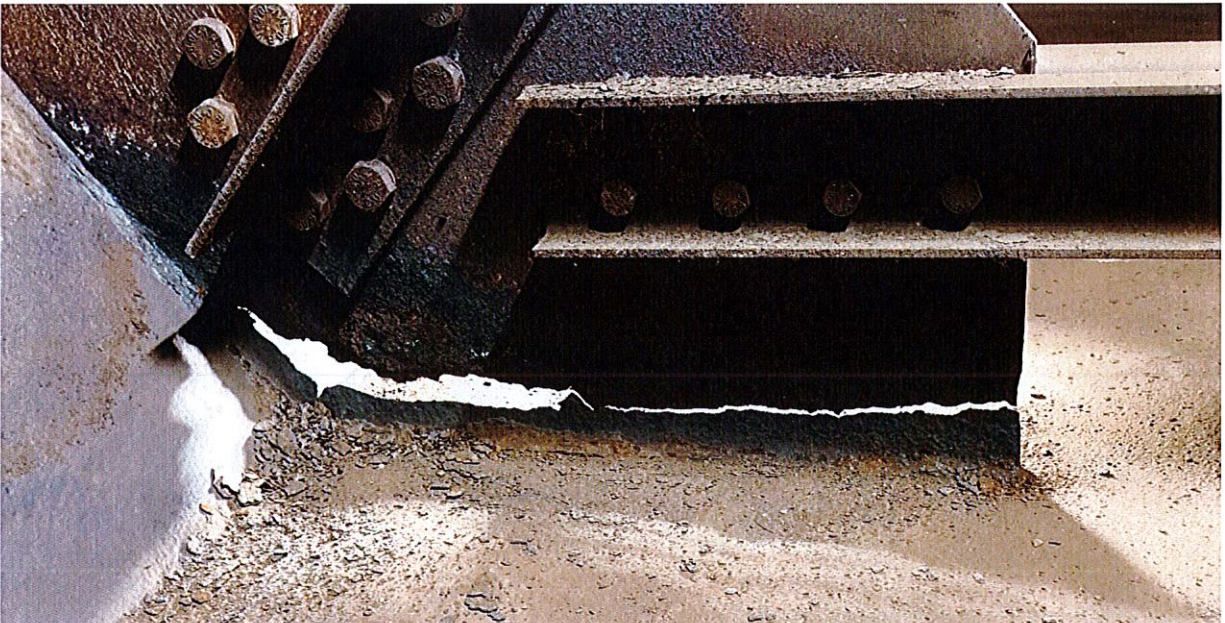
Foto 8 – esempio di perdita totale di sezione del nodo bullonato di base del diaframma. Tale situazione è riscontrabile, in maniera più o meno accentuata, in molti diaframmi in tutte le campate dalla 2 alla 7.
