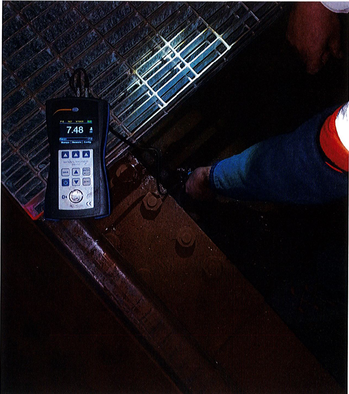
Foto 6 - Campata 6 giunto G4 – riduzione dello spessore del coprigiunto centrale da 15 mm originari a 7,48 mm rilevati
