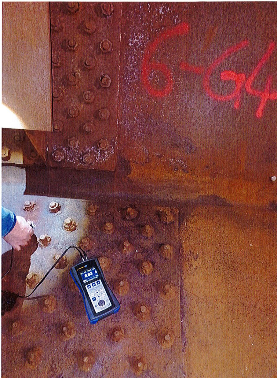
Foto 5 - Campata 6 giunto G4 – riduzione dello spessore del coprigiunto laterale sud da 15 mm originari a 8,83 mm rilevati
