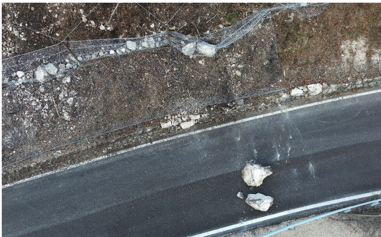
Immagine n. 3 – Massi presenti lungo la sede stradale (data presa 12.02.2024)
