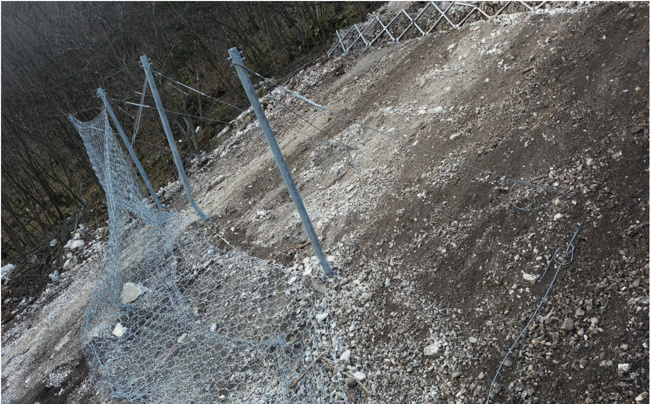
Immagine n. 4 – Barriera Paramassi B 5000 KJ (data presa 12.02.2024)
