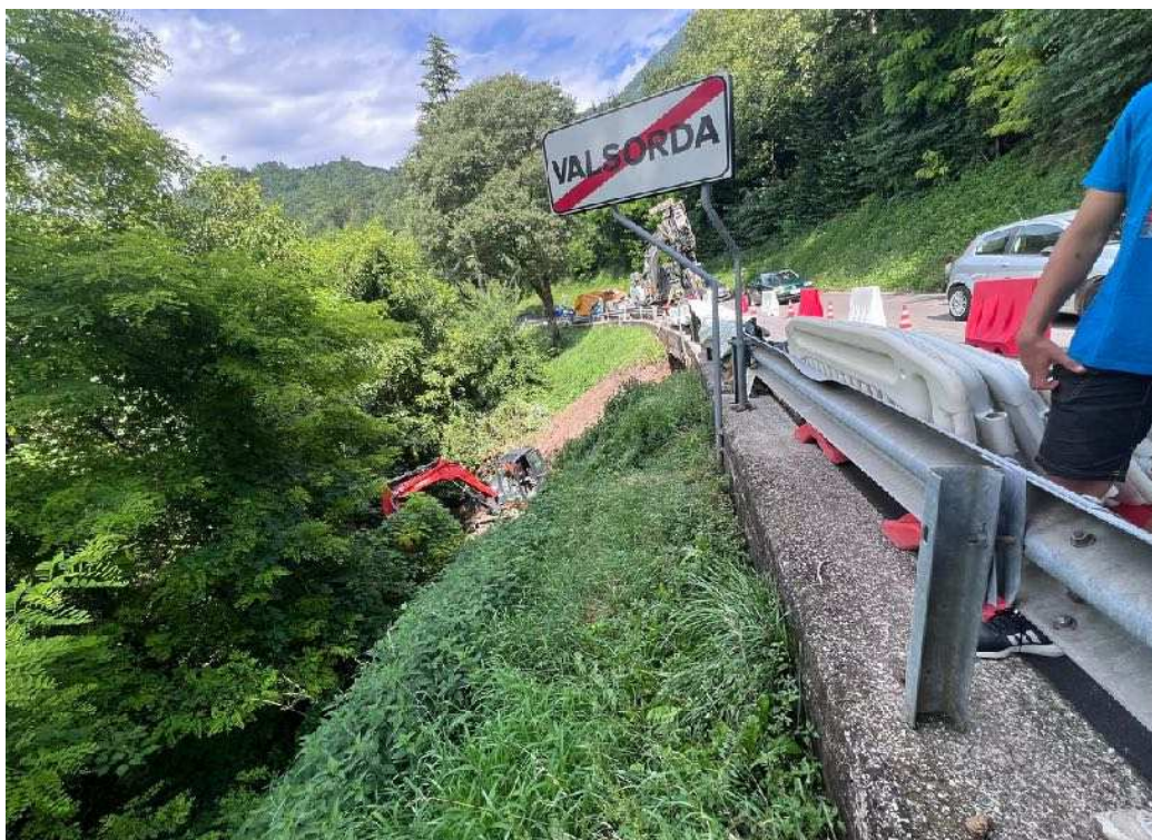
Foto 4: area del dissesto vista da monte
