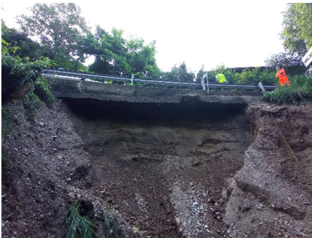
Foto 5: area del dissesto vista da valle
