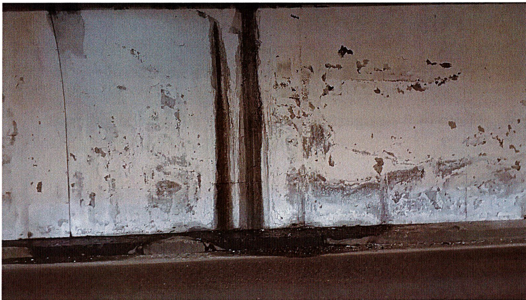
Foto n. 4 e n. 5 - ristagni sulla carreggiata e percolazioni sul marciapiede nella galleria Limarò.
