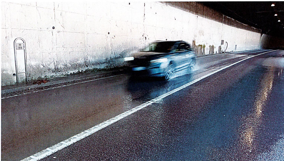
Foto n. 1 e n. 2 – ristagni sulla carreggiata nella galleria Limarò.
