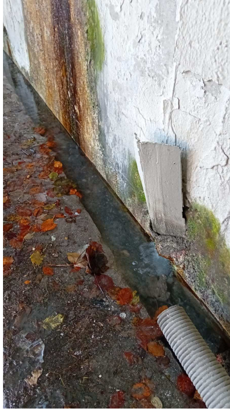
Foto n. 10 – apporto di acque dalla volta nella galleria Limarò
