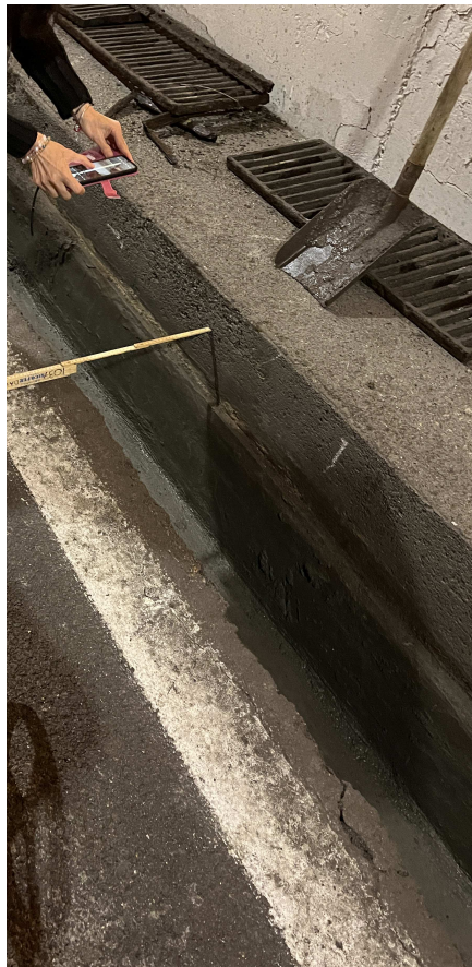
Foto n. 11 – griglie danneggiate nella galleria Limarò
