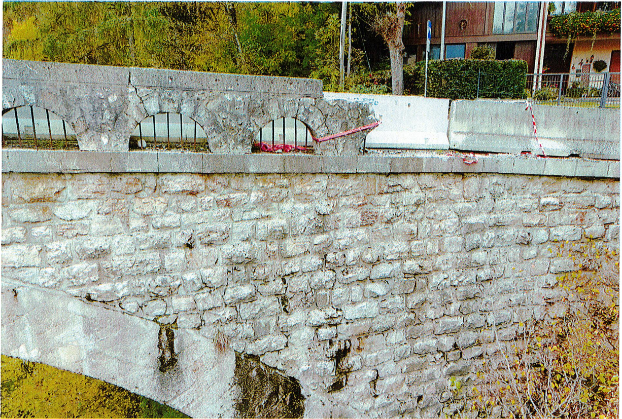
Foto n. 2 – SS 238 delle Palade dir innesto SS 42. In primo piano il tratto del parapetto del ponte danneggiato a seguito dell'incidente dd. 8 ottobre 2024.
