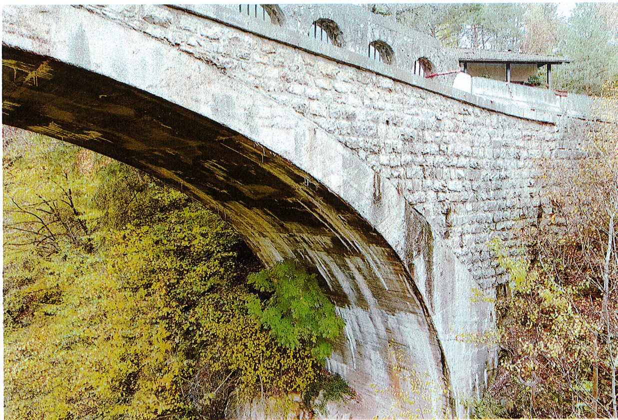
Foto n. 1 – SS 238 delle..el Palade dir innesto SS 42. Vista del ponte sul riop Sass ripreso da valle. Si riconosce la parte dell'originario parapetto rimossa in quanto in equilibrio instabile a seguito dell'urto da parte di un autoarticolato avvenuto in data 8 ottobre 2024.
