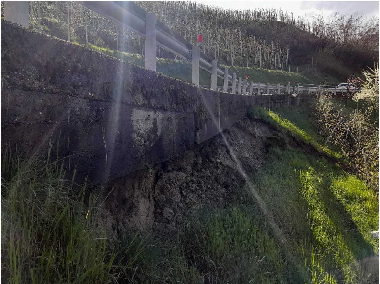
2 Vista dello smottamento a valle della struttura di sostegno. Si noti la deformazione verticale della struttura di sostegno.
