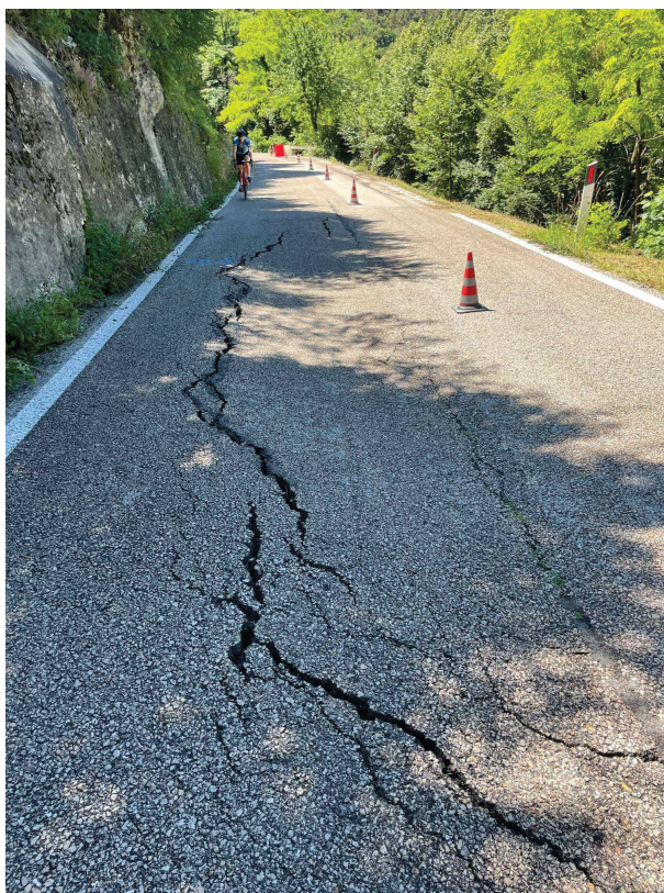
Foto n. 2 – deformazioni della pavimentazione stradale.
