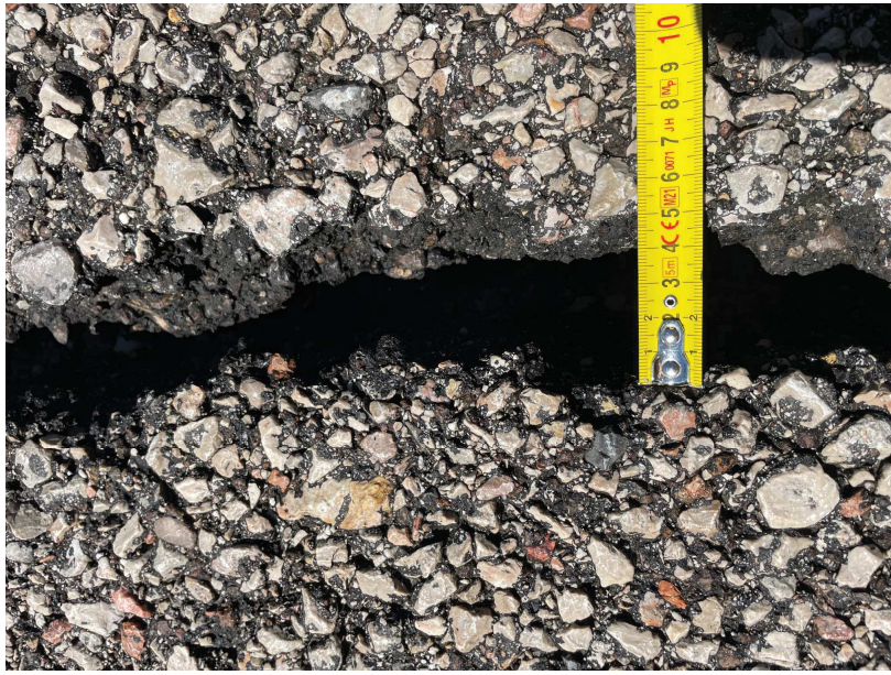
Foto n. 3 – riscontro delle deformazioni in atto.
