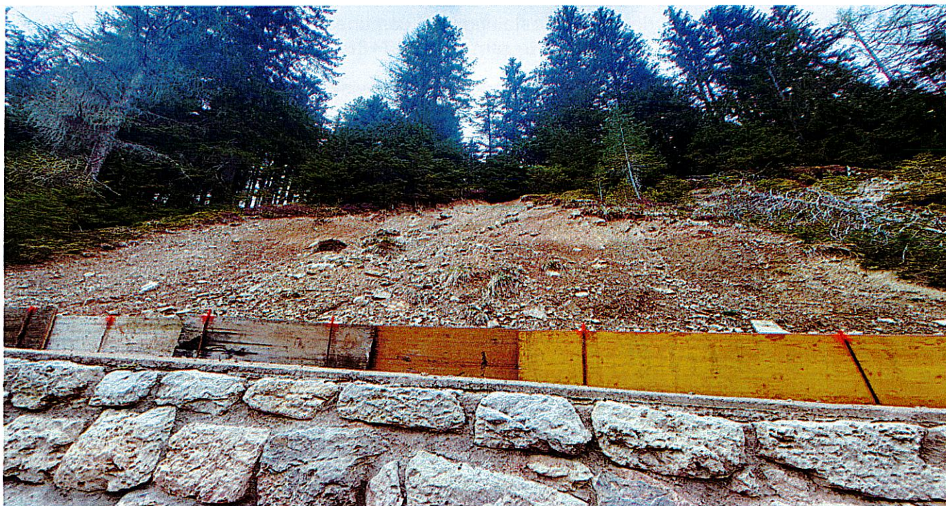
FOTO n. 3 – SS n. 241 del passo Costalunga nel comune di San Giovanni di Fassa Franamento rampa km 31+680
