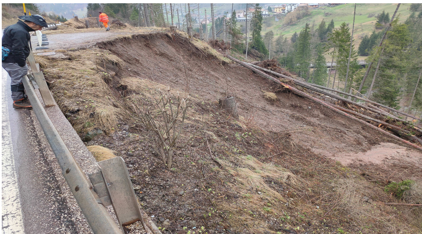
FOTO n. 4 – SS n. 346 passo San Pellgrino nel comune di Moena Cedimento versante e alberi km 1+700
