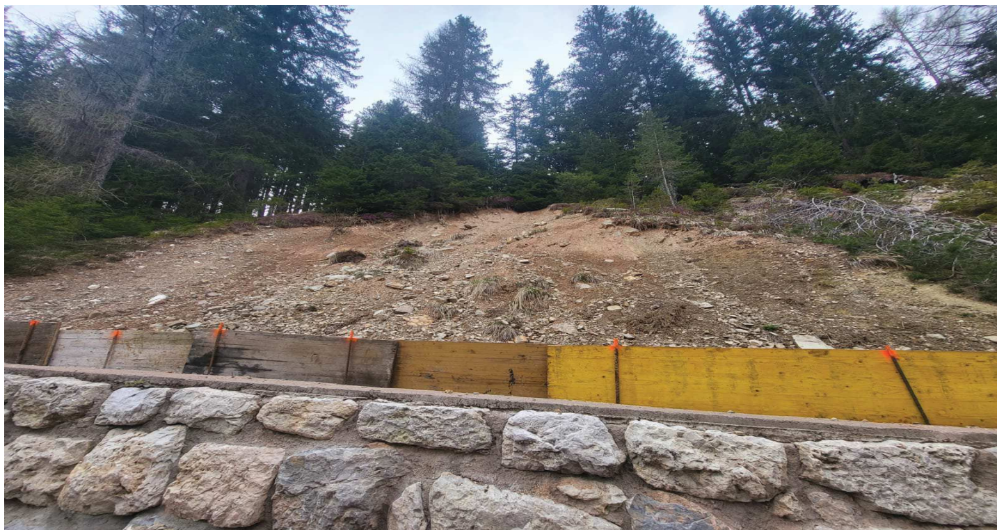
FOTO n. 3 – SS n. 241 del passo Costalunga nel comune di San Giovanni di Fassa Franamento rampa km 31+700
