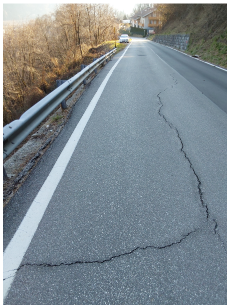
Figura 2: Vista della carreggiata stradale lesionata
