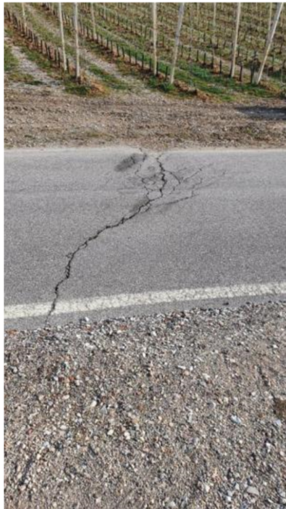
Foto 6: fessurazioni trasversali al km 0+400 (foto aprile 2020).
