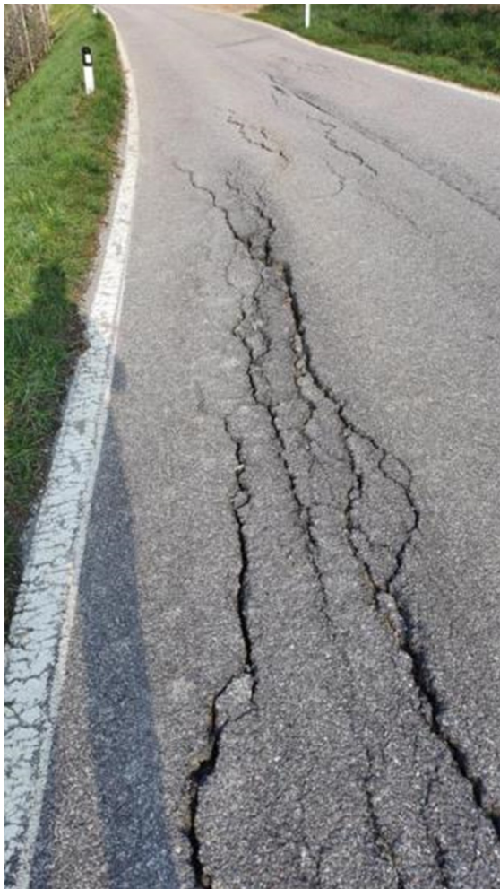
Foto 5: fessurazioni longitudinali al km 0+400 (foto aprile 2020).
