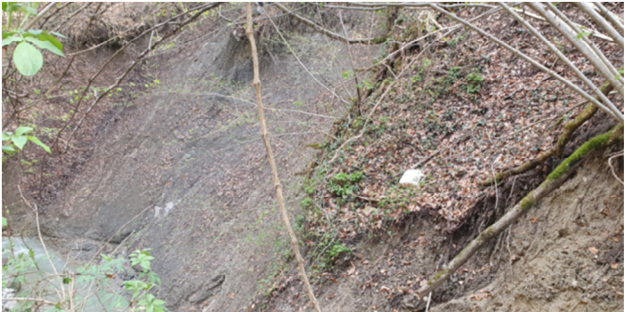
Foto 4: alveo del rio Belasio alla base del versante (circa 60 m a valle della strada). L'alveo è inciso nella roccia marnosa. In basso a dx si osservano colamenti di materiale limo-argilloso saturo
