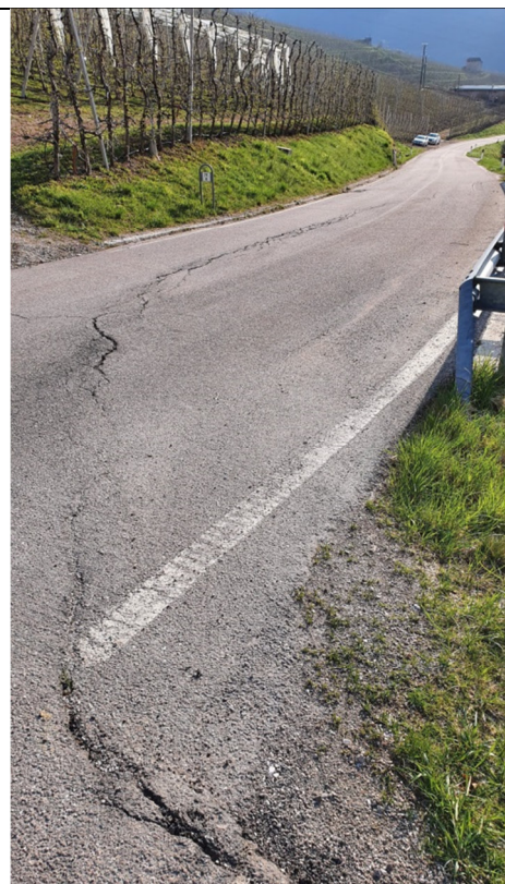
Foto 7: fessurazioni trasversali poco a monte delle precedenti (foto aprile 2020).
