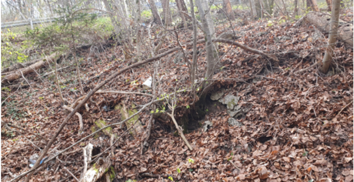
Foto 3: versante boscato a valle della strada. Si possono notare dei fenomeni di dissesto corticale (gradonature e scollamenti) che interessano lo strato di copertura più superficiale
