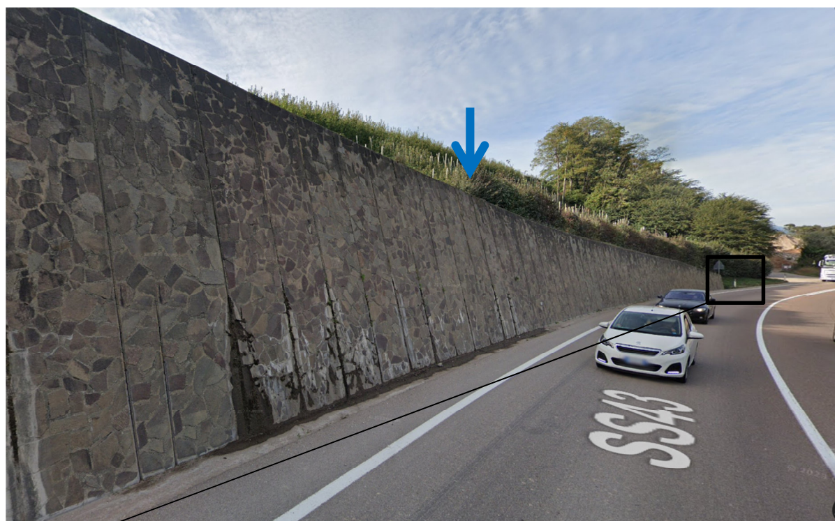
Il muro e la zona in cui si concentrano le acque da monte
