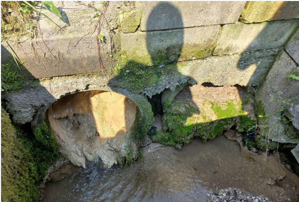
Figura 11: tubazioni in attraversamento della S.S 43 otturate dal calcare
