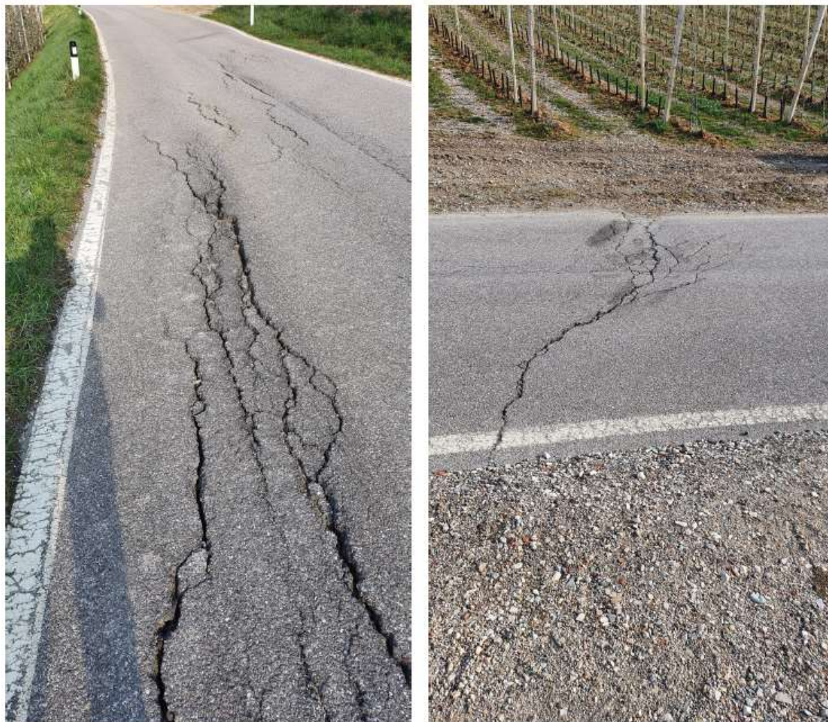
Figura 7: S.P. 55 dir. 2 Lover al km 0+230 - Fessurazioni longitudinali e trasversali
