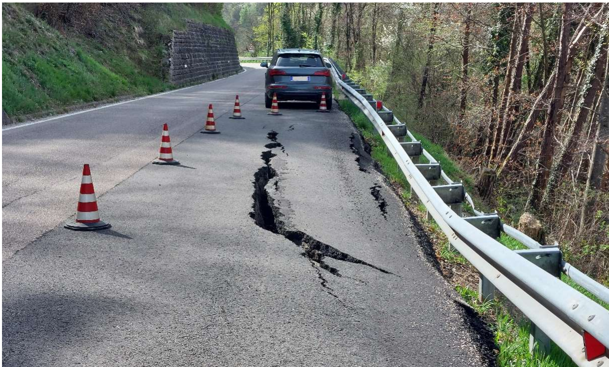
Figura 3: S.P. 55 – fessurazione del manto stradale e cedimento della carreggiata.
