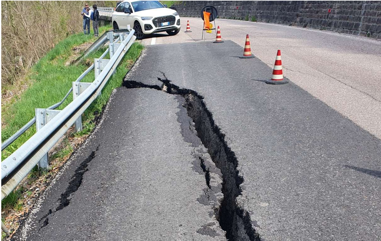
Figura 2: S.P. 55 – fessurazione del manto stradale e cedimento della carreggiata.
