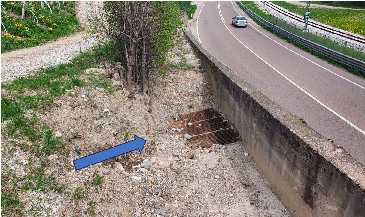
Figura 10: pozzetto di arrivo delle acque meteoriche.
