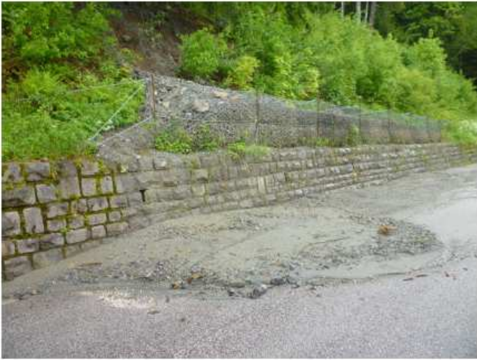
Le reti paramassi colmate dalle colate detritiche
