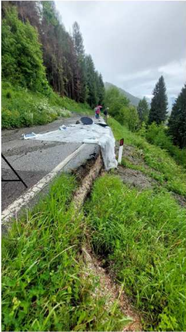
Cedimento della scarpata a valle della S.P. n° 135
