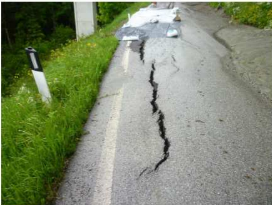
Fessure nel manto stradale
