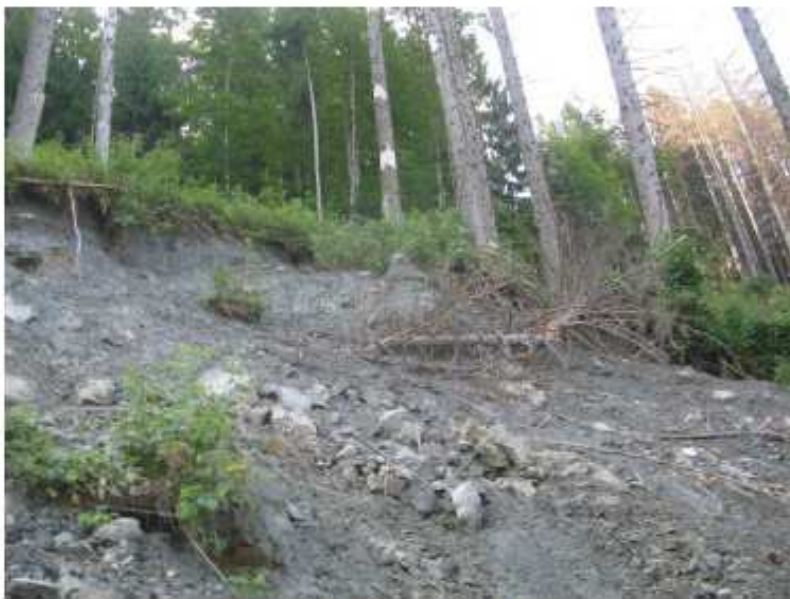
Niochia di frana e colata detritica
