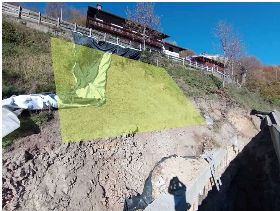
Foto 2.2: vista sulla zona sommitale del versante, da dove ha avuto origine il dissesto, da rivestire con rete a doppia torsione in acciaio accoppiata con geo rete, armata con funi. Gli ancoraggi autoperforanti saranno indicativamente di lunghezza 3 – 4 m (da valutarsi in c.o.)
