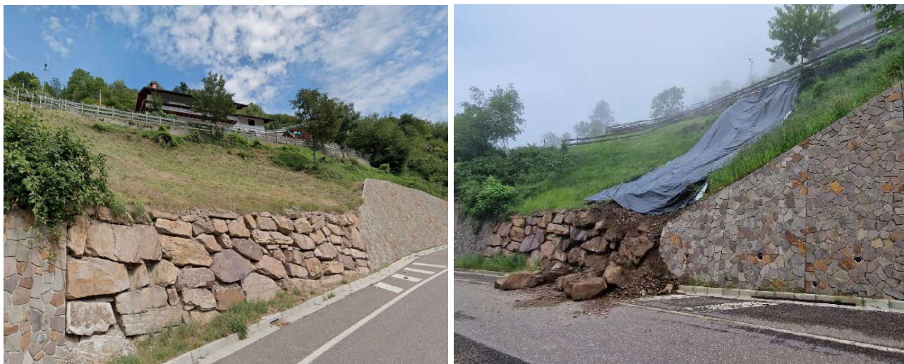
Foto 1.1 e 1.2: il muro prima e dopo il dissesto.
