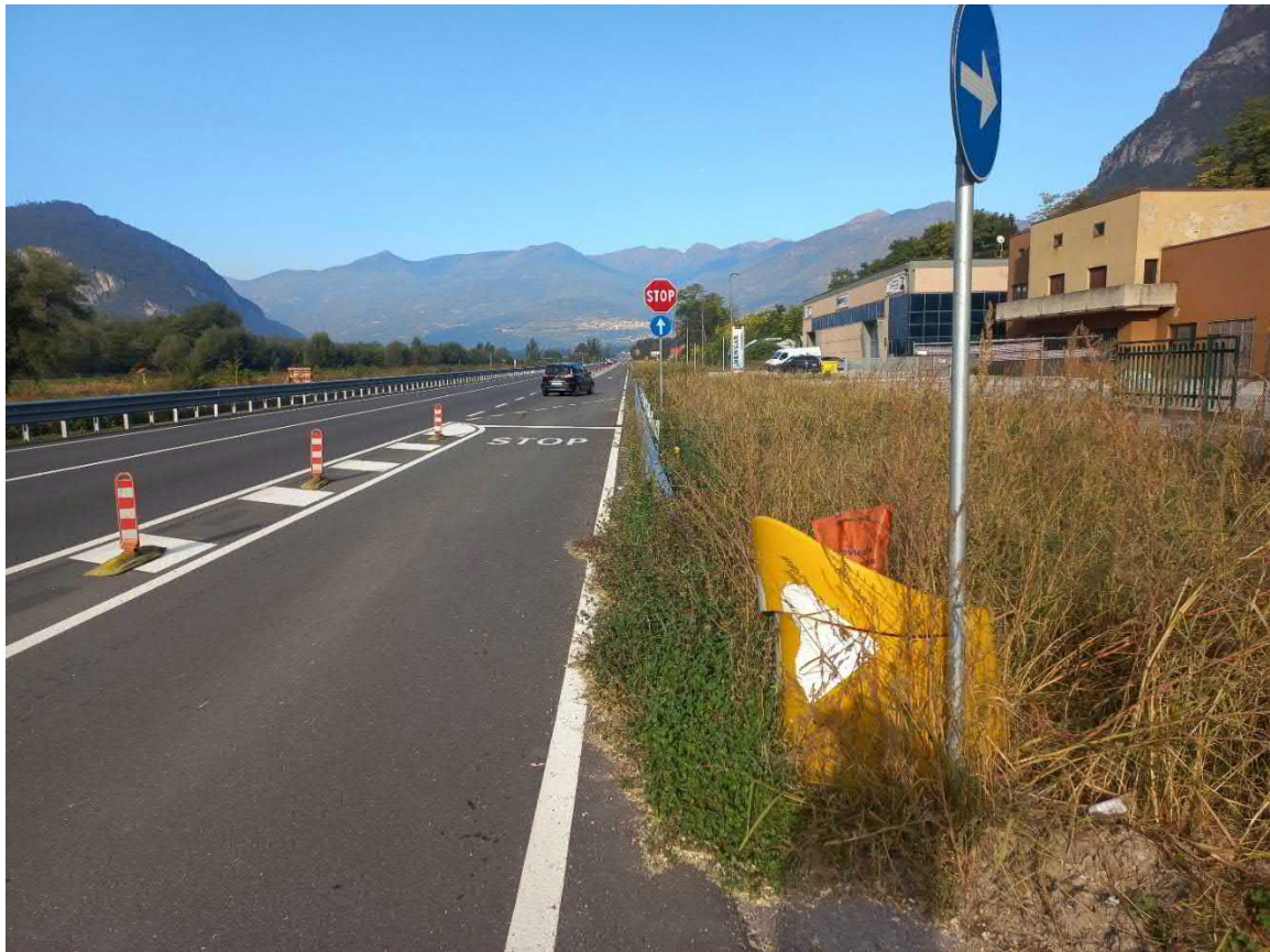
Figura 19 – Corsia di entrata e assenza di banchina esterna destra
