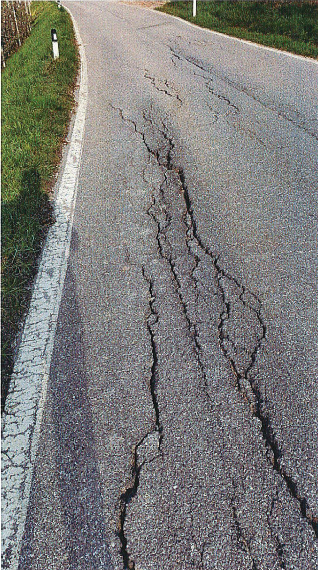
Foto 1: vista fessurazioni longitudinali al km 0+400
