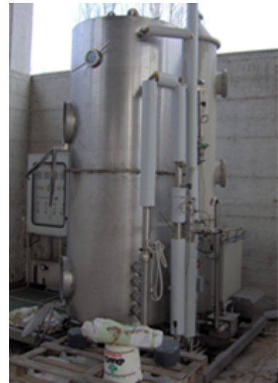
Fig. 6: colonna di strippaggio
